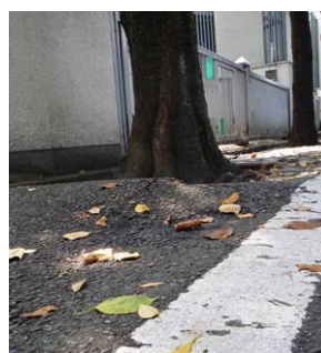
根が道路の下に入り、アスファルトを持ち上げている。
